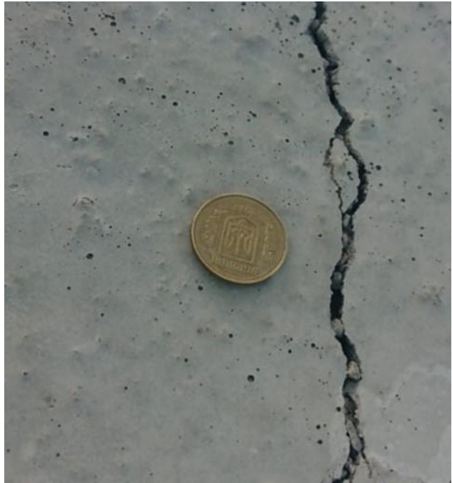
Fig 4 New Concrete cracked 28 days old pour
